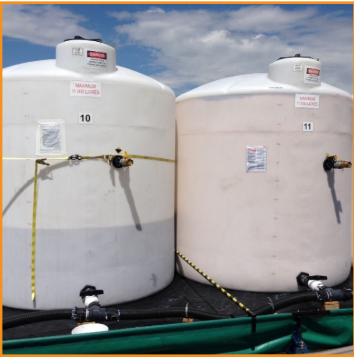
Figure 2 : Réservoirs de Btk installés à l'intérieur d'un bassin de rétention
